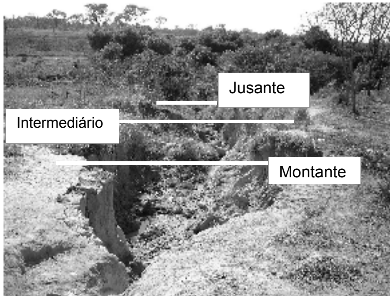
Figura 4 – Ilustra aproximadamente os pontos de monitoramento ao longo da voçoroca-Autor: Reis – 04/2003
